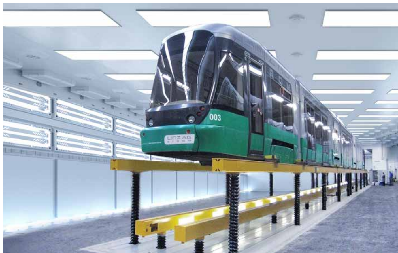
Installation de levage en fosse de la marque Pfaff avec des éléments de levage à vis SHE 25 conçus conformément à la norme DIN EN 1493.
